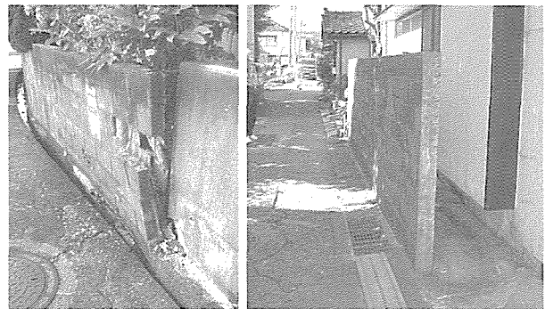
ア) 配筋で転倒を免れたブロック塀
