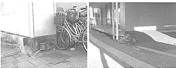
図25 商業ビルの基礎・地盤被害（柏崎市）
