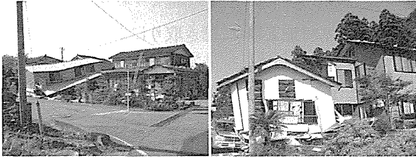
図11 納屋や車庫の被害（刈羽村、西山町）
