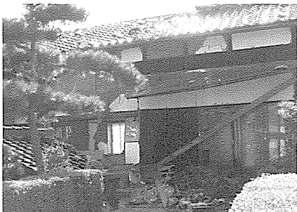
図2 漆喰の剥落（刈羽村）
