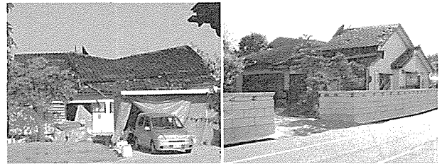
図14 小屋組みの崩壊（刈羽村）
