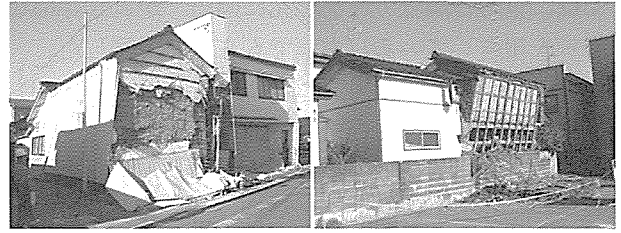
図3 振動や塀への衝突による塗土の脱落（柏崎市）
