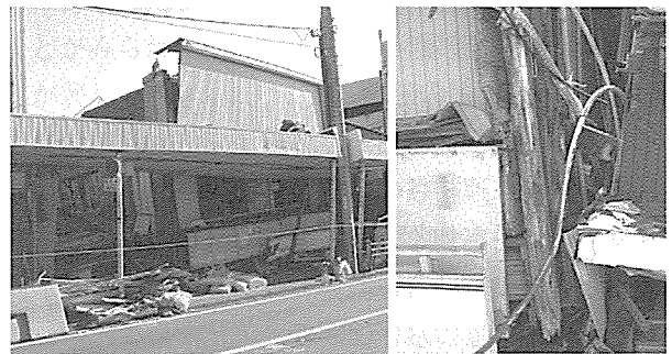
図9 店舗の被害(柏崎市閻魔堂通り商店街)
