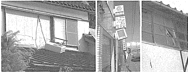
図31 落下の危険がある非構造材(西山町、柏崎市、刈羽村)
