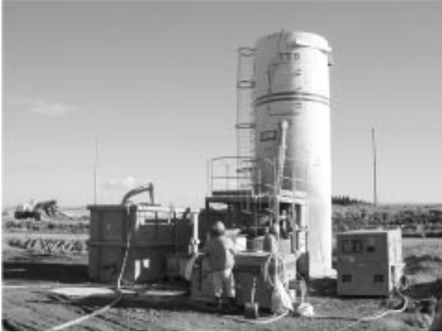
Photo 2 設置された固化材スラリープラントの例 Example of facility and machines in typical slurry plant
