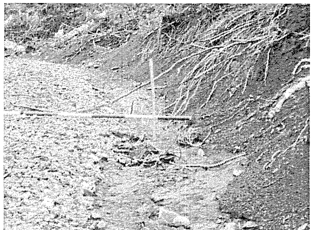
写真4 妙高市杉野沢 (H21.6) 隣接作業路の素堀側溝の洗掘状況
