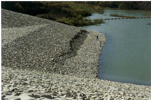
Fig. 10 右岸地山ブランケット保護層の被災 Damage of protective layer of blanket at right abutment
