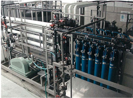
図2 プラント (UF/ROユニット)
