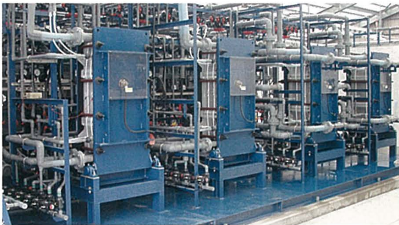
図3 プラント (EDユニット)
