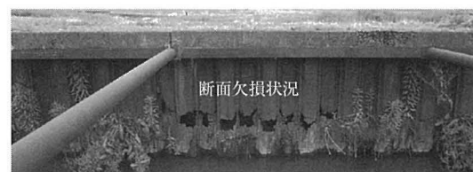
(b) 腐食が進行した鋼矢板区間
