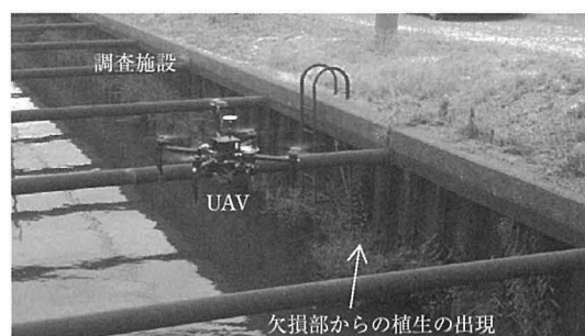
写真-1 鋼矢板水路の腐食実態と UAV による調査例
