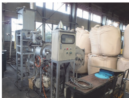
図 41-5 チャー燃烧バーナーシステム
